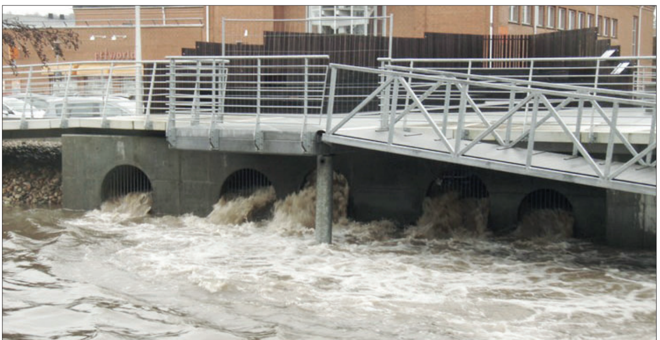
Sluse- og pumpebygværket i drift.
