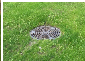
Rist i terræn i bunden af klimarenden. Vandet kommer op af risten, når 1000 ledningens kapacitet er brugt.
